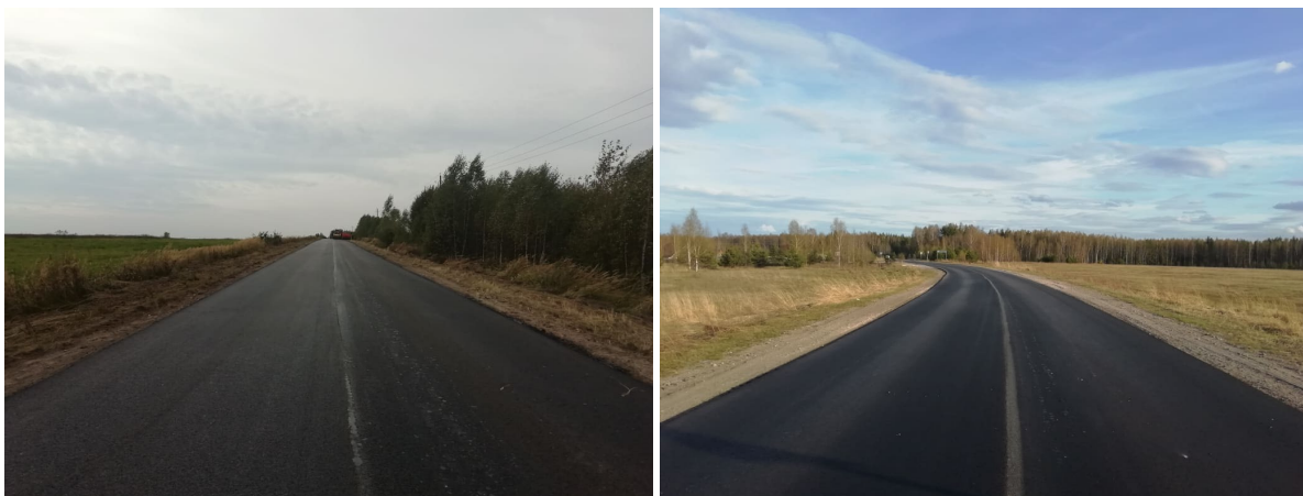
Рис. 9. Акт комиссионного обследования контрольного участка с ROADLINER MBNB-P
