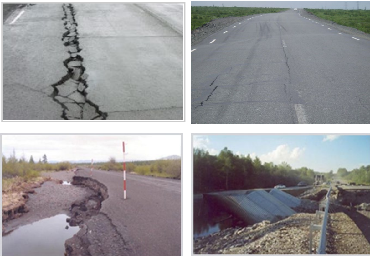
Рис. 1. Продольные трещины, просадки земляного полотна, обусловленные оттаиванием многолетнемерзлых грунтов подстилающего основания; размывы паводковыми водами Fig. 1. Longitudinal cracks, subsidence of the roadbed caused by thawing of permafrost soils of the underlying foundation; wash due to flood
